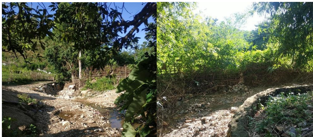
Gambar 1.9 Material Debris pada Drainase Primer Sambinae
